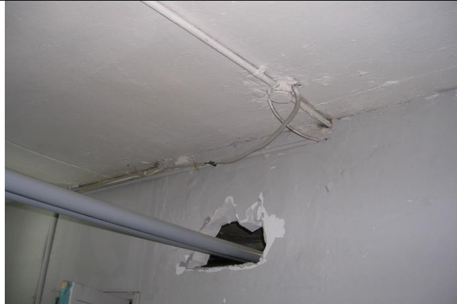
Отсутствует огнезащитная заделка проемов
