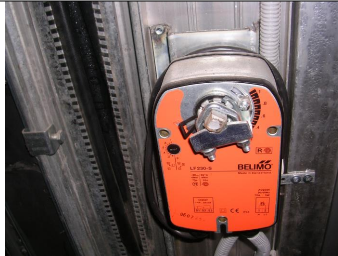
Привод управления жалюзи заблокирован, что может вызвать аварию на теплообменнике ПК
