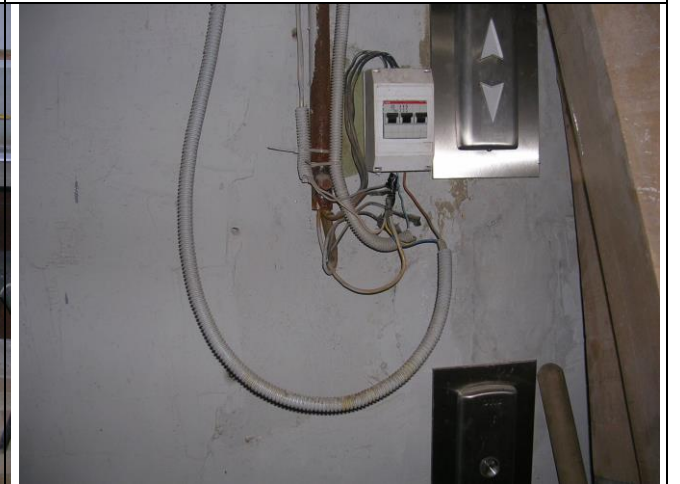
Сети освещения и розеточных групп, включая светильники, находятся в состоянии, запрещенном к эксплуатации ПЭЭП (Правила эксплуатации электроустановок потребителей)
