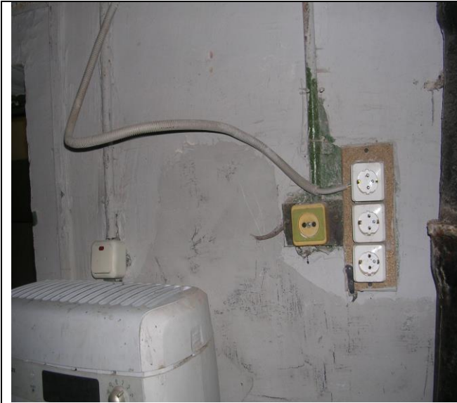
Нарушение условий электромонтажа.
