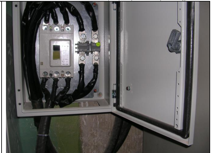
Нарушение требований ПУЭ по электромонтажу, прокладке кабелей и заземлению металлических частей электрощитов.
