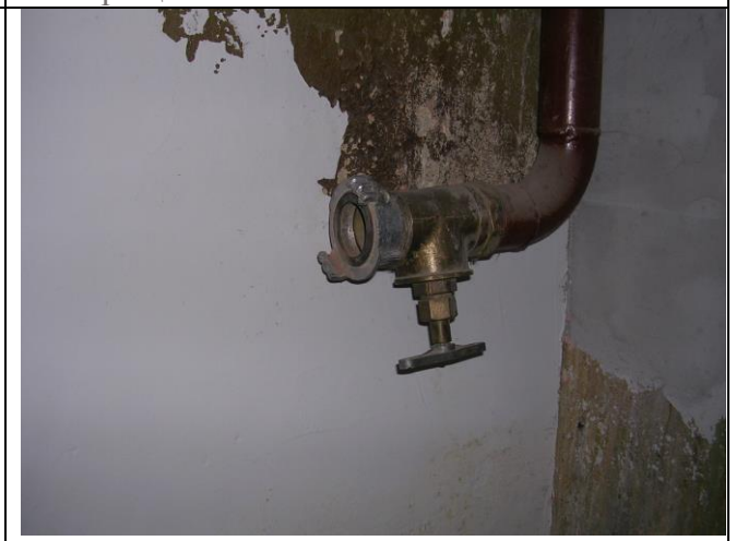
Нарушение противопожарного режима. Отсутствие подключенных рукавов и огнетушителей в помещениях.
