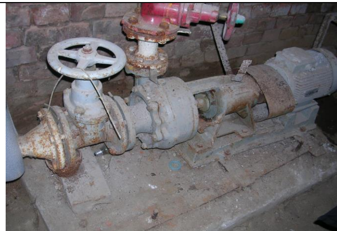
Насосная станция не в рабочем состоянии. Отсутствуют пожарные рукава. Испытания на водоотдачу не проводились.
