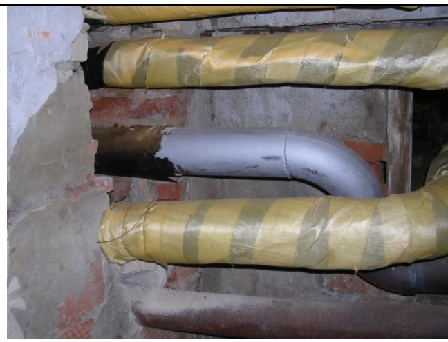
Отсутствие заполнения проемов. Некачественная гидро и теплоизоляция трубопроводов.
