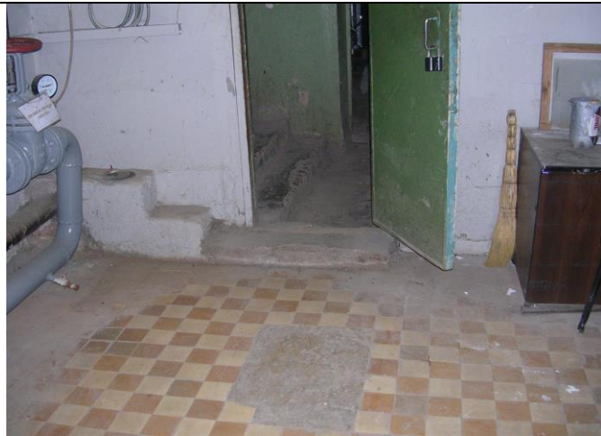
Отсутствуют дренажные лотки и приямки, в аварийных случаях возможно затопление подвального помещения.
