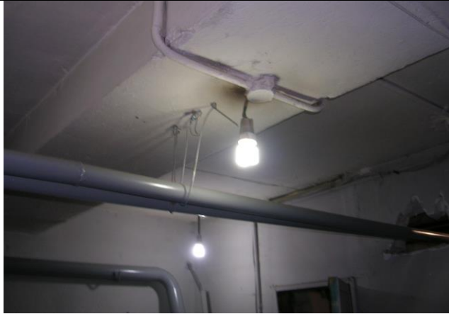
Отсутствует противопожарная сигнализация. Светильники без защитных кожухов.
