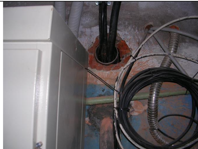
Нарушение условий прокладки коммуникаций по противопожарным требованиям.
