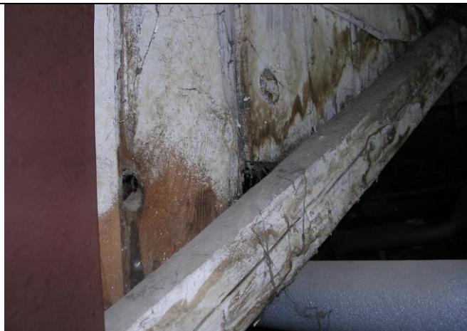
Отсутствует огнезащита строительных конструкций.
