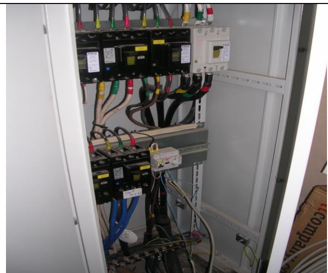
Нарушение условий электромонтажа в щите.
