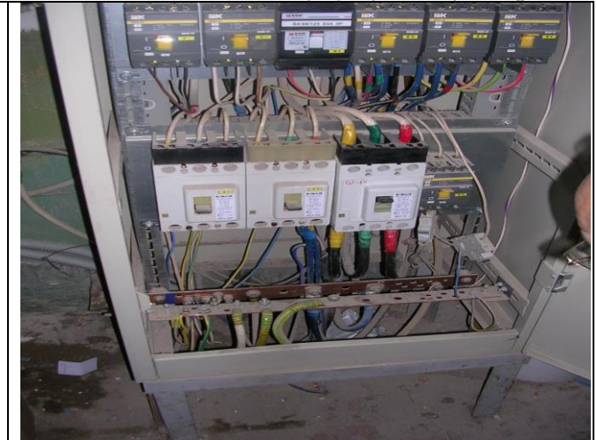
Электрощиты не отмаркированы. Электроразводка не пронумерована в соответствии со схемой и ПУЭ (Правилами Устройства Электроустановок). Обслуживание электрооборудования не проводится.
