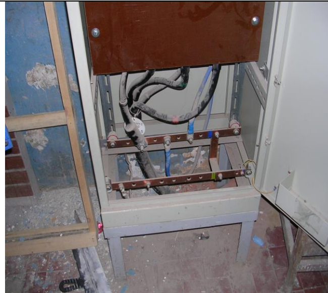
ТО не проводится. Нарушение ПУЭ.
